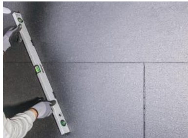
Şekil 2 Yalıtım levhaları, duvarla tam temas edecek şekilde hafifçe kaydırılarak duvara yapıştırılır. Levha seviyelerinin kontrolü master veya su terazisiyle sağlanmalıdır.
