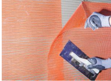
Şekil 2 Donatı filesi, henüz kurumamış ilk kat yüzey sıvasının üzerine, yukarıdan aşağıya doğru bastırılarak ve iyice gerilerek, katlanmadan ve yalıtım levhasından tüm yüzeye eşit uzaklıkta olacak şekilde yerleştirilmelidir. Birleşim yerlerinde donatı filesi, her zaman 10 cm üst üste bindirilerek uygulanmalıdır.
