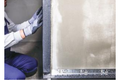
Şekil 3 Aralarında 2-3 mm mesafe bırakılarak uç uca eklenen su basman profillerinin ölçüsü kullanılacak ısı yalıtım levhasının kalınlığına uygun olarak seçilmelidir.
